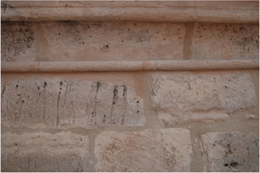
Figura 12: Detalle del paño B en el nivel 7. Piedra con lesiones vermiformes severas y a su derecha piedra con antigua exfoliación en la parte inferior.
