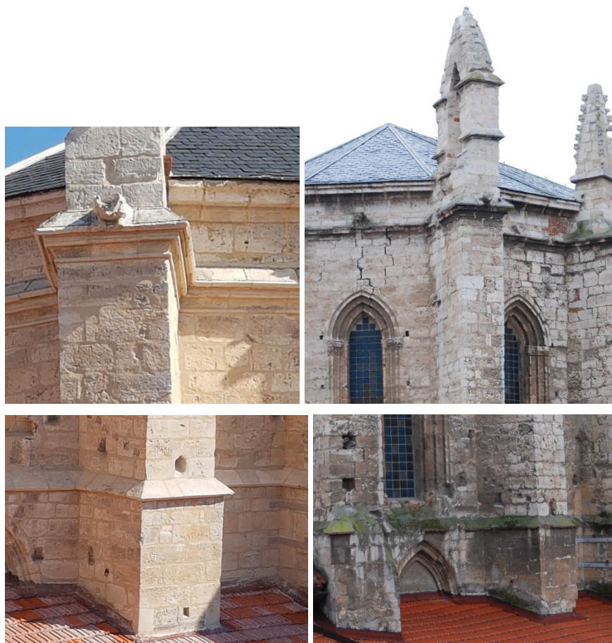
Figura 7: Después de la intervención: limpieza de biologías y costras negras, cosido de grietas, reintegración de piedras nuevas. Antes de la intervención (derecha): colonias vegetales, costras negras, escorrentía de agua de lluvia, grietas, rotura de cornisas y molduras.
