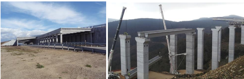
FIGURA 3. Ejemplo de puente pérgola de vigas prefabricadas (izquierda) e izado de la viga prefabricada para su colocación en un puente (derecha).
