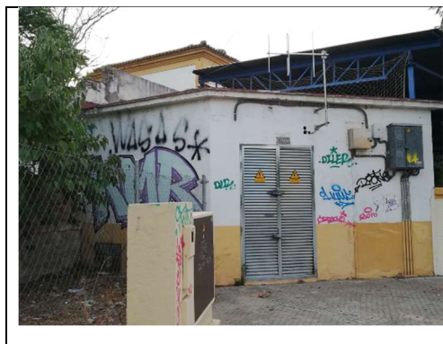
Figura 7. Fotografía tomada en 2019 de la Caseta de transformador eléctrico en la calle Campamento, en el barrio de San Bernardo de Sevilla. Es ejemplo elocuente del resultado al que conduce el descuido de la arquitectura.
