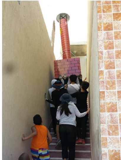
Figura 3: Extensor de chimenea para una panadería Fuente. iENERGÍA
