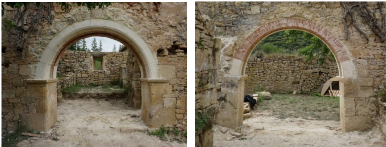
Figura 9. Vistas del arco construido desde el exterior (izda) y desde el interior (dcha). Fuente: MUCRPA
