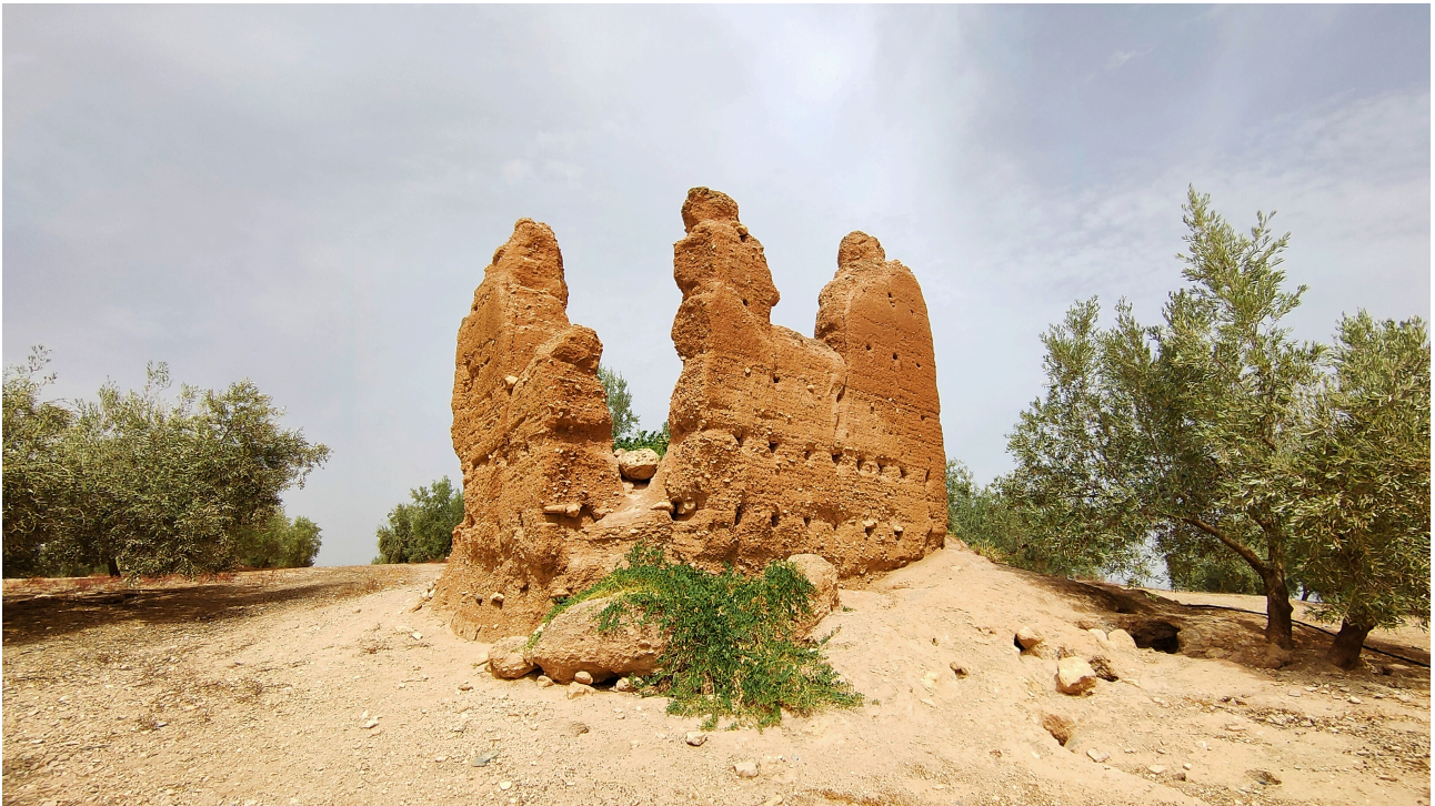
FIGURA 2. Torre del Bordonal, una de las que peor estado de conservación presenta.
