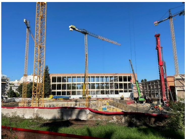
FIGURA 5: Se observa la destrucción de los Almacenes de Rama nº1 y nº2, de las edificaciones auxiliares y del edificio de Oficinas y Talleres. Se conserva la fachada hacia el río de los Almacenes de Rama y tan sólo las fachadas perimetrales y una crujía de la estructura del edificio de Talleres
