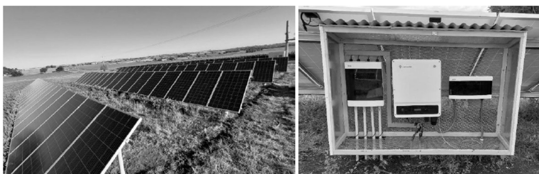
Fig. 2. Montaje final de los cuatro strings de paneles fotovoltaicos (izquierda) e inversor y tableros (derecha).
