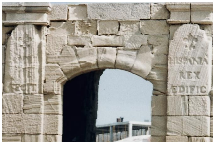
FIGURA 1. Puerta de San Gabriel (Tabarca), donde se observan claros signos de disgregación y pérdida de material por erosión marina y exposición ambiental prolongada.
