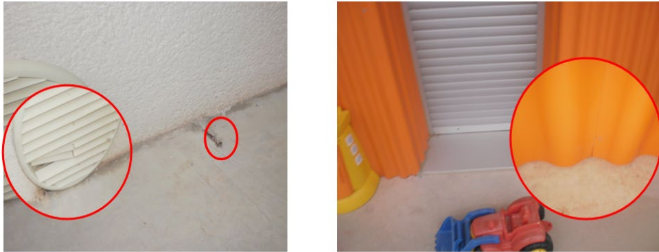
Figura 3. Ejemplo de falta de mantenimiento
